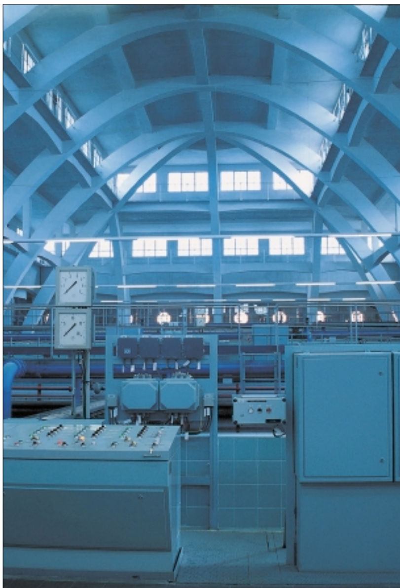
□ Pražské vodovody a kanalizace, a. s. – Podolí waterworks interior
