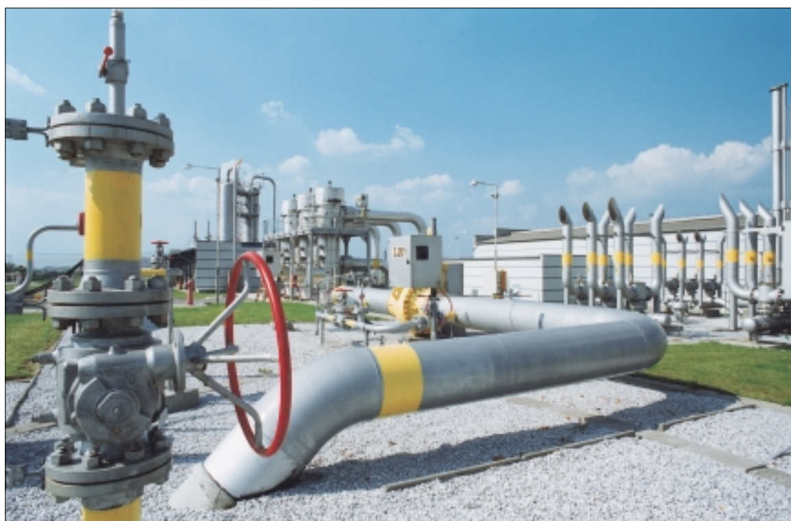
■ Transgas, a. s. – natural gas underground reservoir in Háje - Příbram
