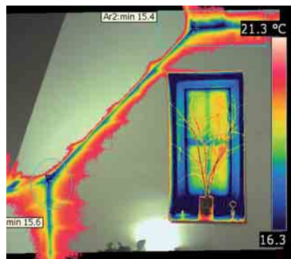
Termovizní snímek tepelných mostů v interiéru objektu
